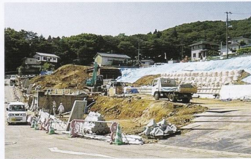
写真5 2011年東北地方太平洋沖地震で宅地造成地が被災した仙台市青葉区折立地区の状況 (撮影：2014.7.)
