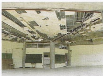
写真25 円形校舎1階部分の被災状況(2013.6.1.撮影)
