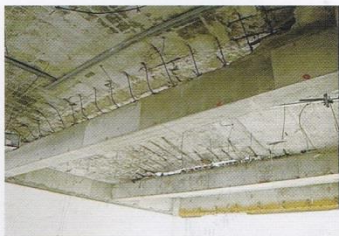
写真29 1階から見上げた写真28と同一場所(2013.6.20.撮影) 津波の力によって床スラブは梁から引き剥がされている。
