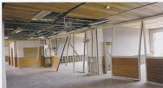
写真08 中浜小学校2階中央スペースの被災状況（2013.9.28.撮影） 児童たちは2階にしばらく待機しており、津波来襲の前に屋上に移動して助かった。
