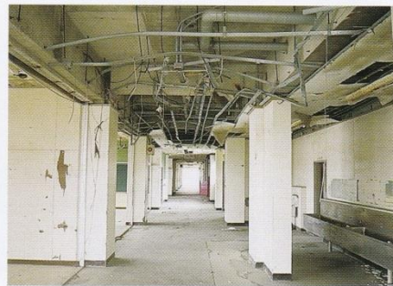
写真03 荒浜小学校1階廊下の被災状況(2013.4.20.撮影)
