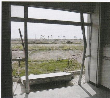
写真04 荒浜小学校2階廊下妻面の被災状況(2013.4.20.撮影) 津波はこの海側妻面から2階にまで侵入していた。
