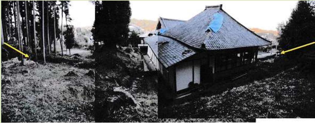
寺の本堂を通過した地表地震断層。本堂は手前側に傾斜しているが、屋根瓦はあまり落下していない。写真の左端の樹木の後ろに倒壊した山門がある。
