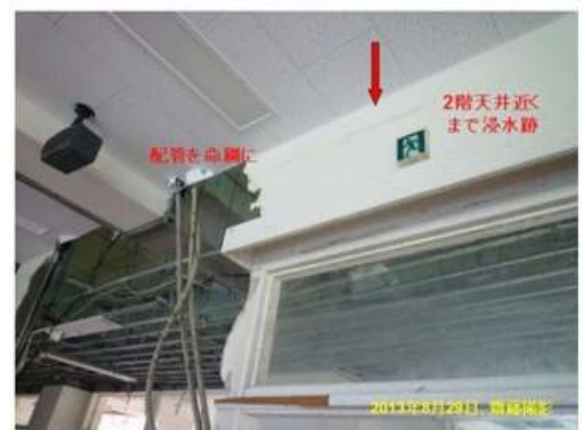
防災センターの被害(上)破壊された待合ホール、(下)2階天井まで浸水した痕跡(写真提供:齋藤徳美氏)
