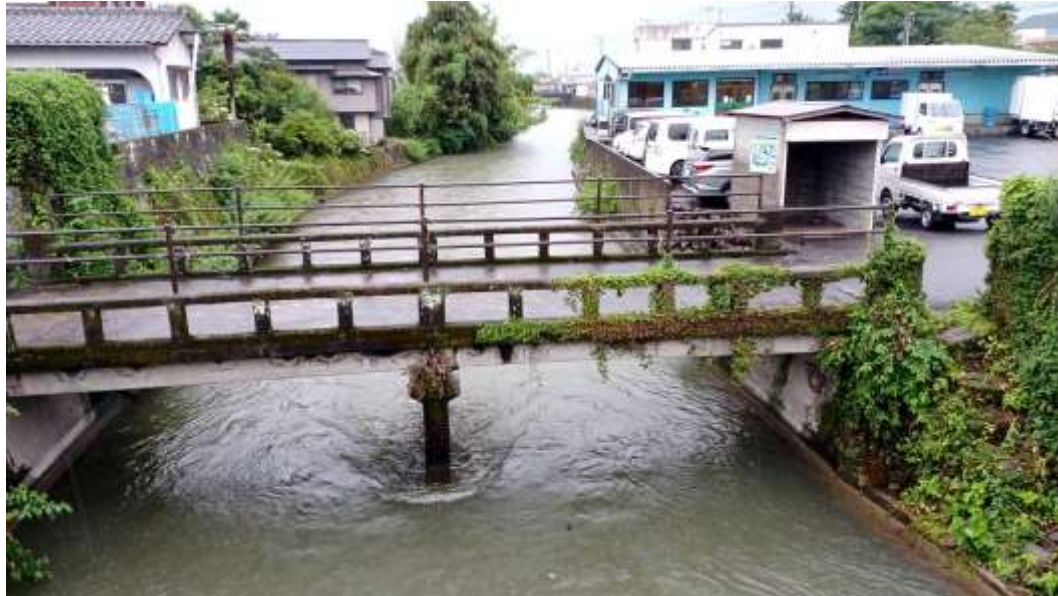
浮羽町高見の町中を通る大石水道
