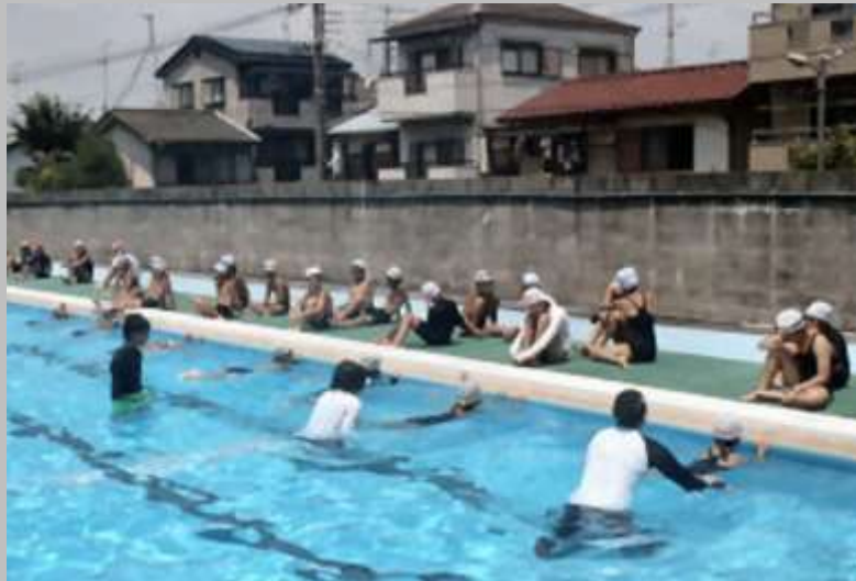
プール側から見た地震前のブロック塀(高槻市教育ネットワーク資料より)
