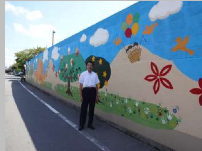
道路側から見た地震前のブロック塀(濱田剛史高槻市長のFacebookより)
