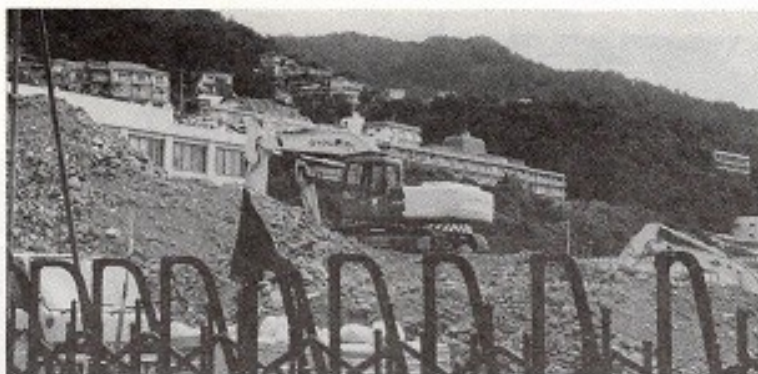
[写真10]甲南大学の被災校舎はすでに撤去されており、その北側の六甲山麓の斜面に開発された無被害の住宅がかえって目に付く（東灘区岡本，6/4撮影）。
