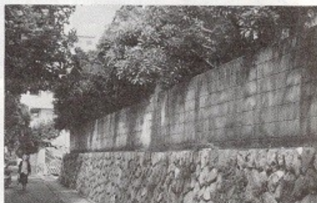
[写真12]阪急JR間の山手幹線に面した無被害のブロック塀と石垣（東灘区岡本，6/4撮影）。
