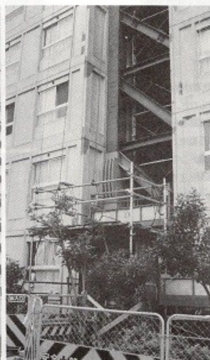
[写真21] 鉄骨主柱2階の脆性破壊部分の補強状況。周辺の住宅隅角部に小被害(同左)。
