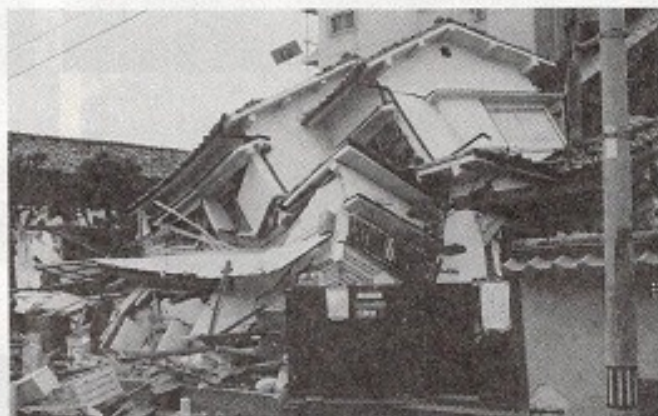
[写真 7]木造住宅の崩壊現場でも回りの塙は被害軽微(芦屋市翠ヶ丘, 1/21撮影)。
