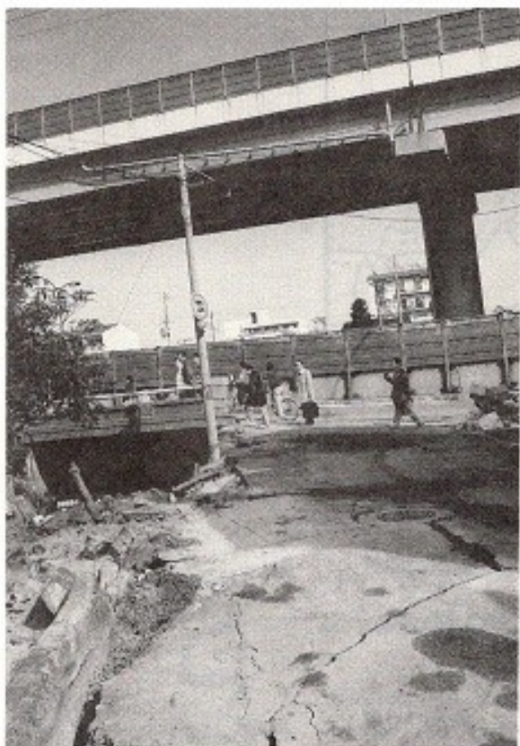
【写真19】津門川付近の阪神高速（西宮市津門住江町，1/21撮影）。被害の多くは小河川の近くで発生している。
