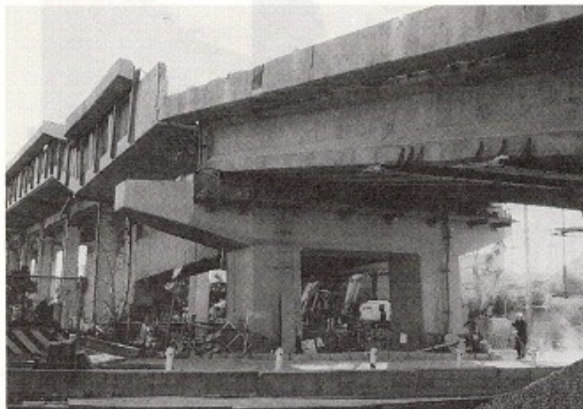
【写真 1】新幹線高架橋の崩壊現場（西宮市上田市，阪急今津線との交差点部，1/21撮影）。長スパンの桁が落下し，支柱は大規模な橋軸方向のせん断破壊による圧壊や沈下を起こしている。その前後の純ラーメン部分では支柱の柱頭に曲げ破壊が連続発生している。
