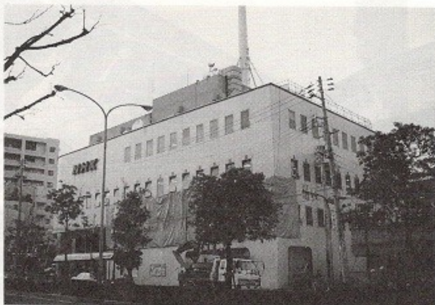
【写真10】NHK神戸支局壁面のせん断亀裂は既にシートで覆われていた（中央区中山手通，1/28撮影）。NHKテレビの被災現場からの第1報はこの建物の前で行われた。また，強震の瞬間を撮影したビデオカメラはこの建物の3階に設置されていた。
