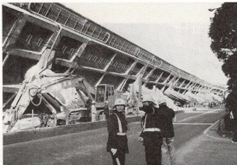
【写真 4】阪神高速道路神戸線の長さ600mにわたる崩壊現場（東灘区深江本町，1/21撮影）。橋軸直交方向への柱脚部の曲げ破壊が崩壊にまで至ったものと考えられる。ピルツ工法による床板の損傷と転倒（北）側の柱脚部曲げ破壊がそれほどひどい状態でないことから、一連の破壊は極めて短時間のうちに連鎖的に発生したのと考えられる。
