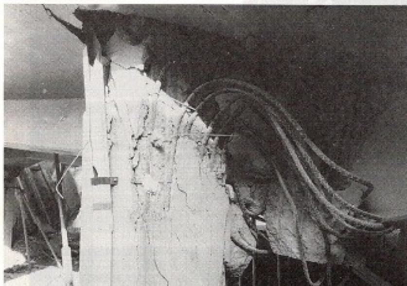
【写真 3】同じく新幹線高架橋純ラーメン部の圧壊（西宮市松籬荘，1/21撮影）。写真2の段階から比較的容易にこの状況に破壊が進行したものと考えられる。帯筋やコンクリート被り厚さの不足，主筋のサビなど施工管理サイドのRC構造の基本についての理解不足による災害（人災）との印象が強い。
