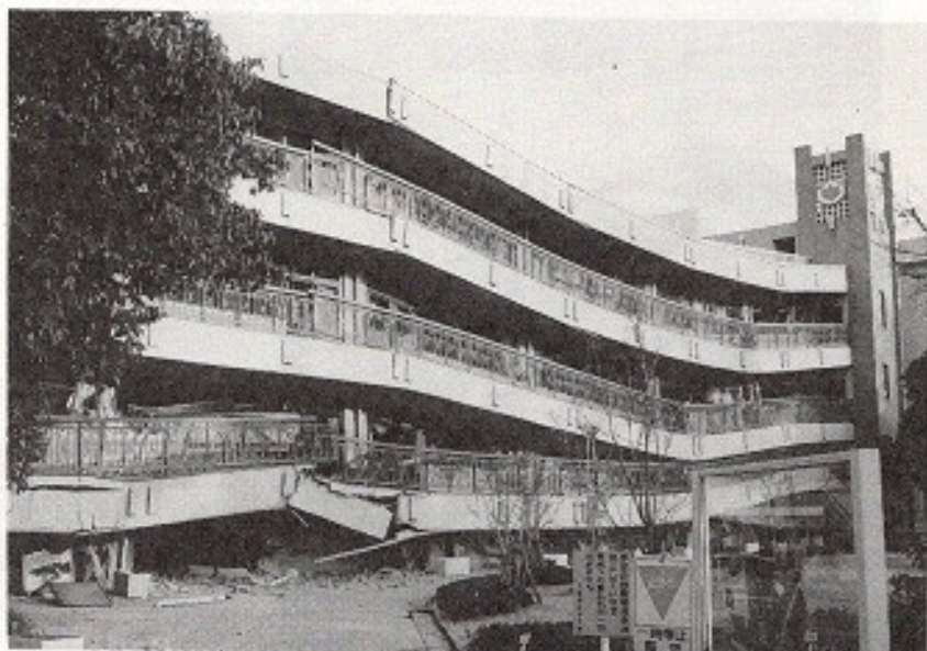
【写真 7】大手前女子大学校舎の崩壊（西宮市御茶家所町，1/21撮影）。構内へ立入っていないため詳細は不明である。1階部分は完全に圧壊しており，隣接校舎も大破している模様であった。
