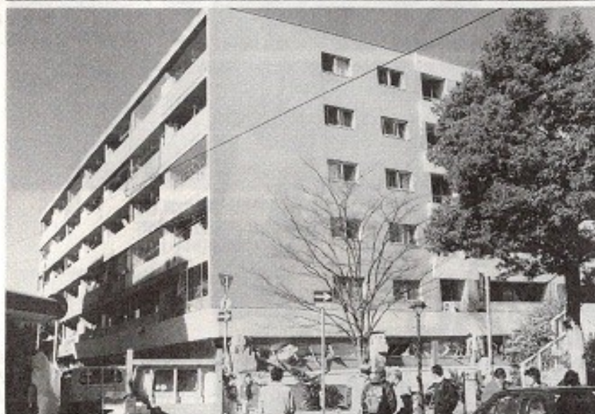
[写真14] 同じくJR摂津本山駅前のマンション（東灘区田中町，1/29撮影）。1～2階の店舗部分が圧壊している。
