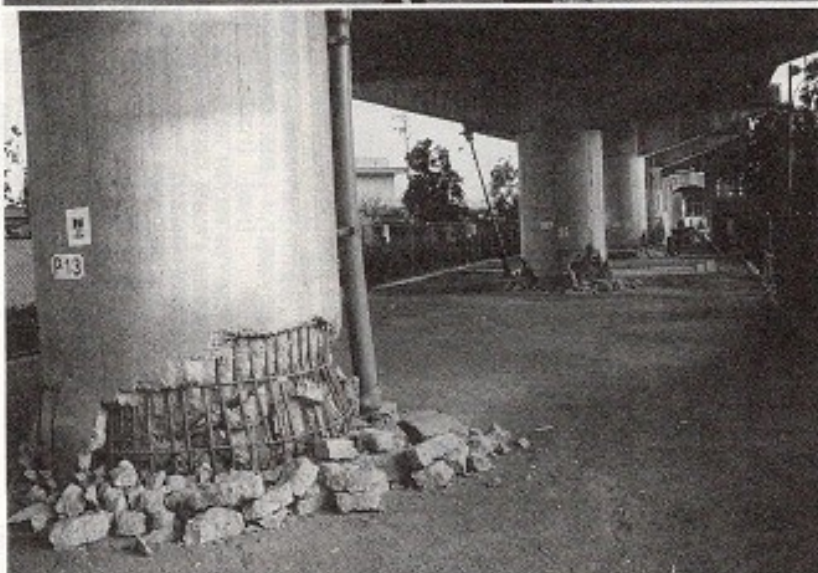
【写真 5】国道171号線の高架部（西宮市甲風園，1/21撮影）でも上記の写真4と類似の柱軸直交方向の曲げ破壊が発生している。両者にどのような条件の差があったのかは判からないが、紙一重であったような気がしないでもない。
