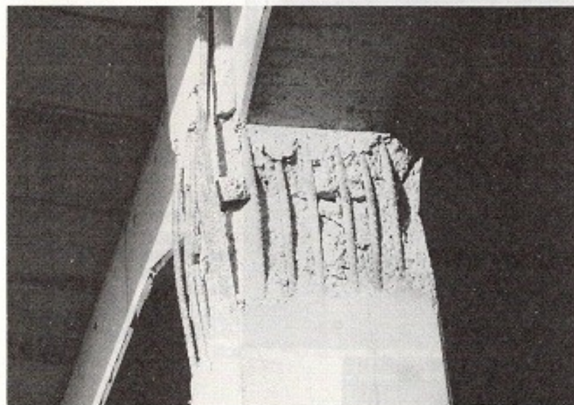
【写真 2】新幹線高架橋純ラーメン部の詳細（西宮市松籬荘，1/21撮影）。柱頭の破壊部分に木片が見えるが，それよりもコンクリートの被り厚さの不足や帯筋が全く見られないことの方が問題かも知れない。
