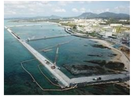
護岸工事が着々と進み土砂投入が予定されている大浦湾＝2018年7月26日午前、名護市辺野古の米軍キャンプ・シュワブ沿岸部（小型無人機で撮影）
