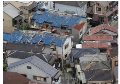
18日、大阪府高槻市では住宅から屋根瓦が崩れ落ちていた。(産経新聞 6/25 より)
