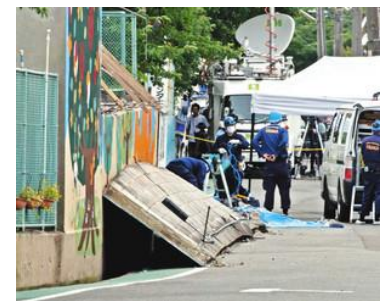
地震で倒壊し、女兒が下敷きになった寿栄小のプールのブロック塀を調べる警察官ら=大阪府高槻市で(東京新聞 6/19より)
