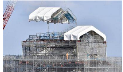
復旧工事が進む熊本城の大天守。覆っていた白い防水シートが外された=4月3日撮影
