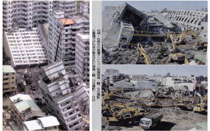
1999年台湾集集地震の際の台中市の被害(左)と今回の地震における台南市の被害(右)
