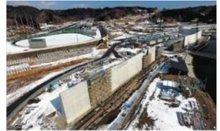
防潮堤の工事が進められた岩手県宮古市田老地区＝2018年（ドローンから）
