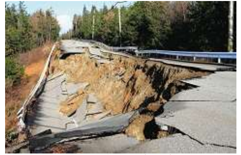
地震による道路の寸断(志賀町)
