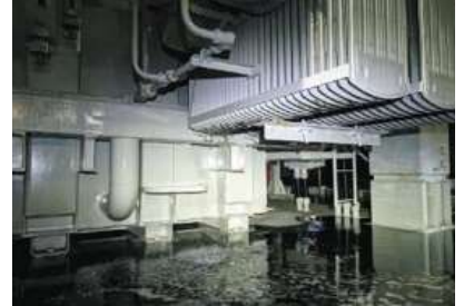
地震による揺れで油漏れを起こした北陸電力志賀原発1号機の変圧器=1日（北陸電力提供）
