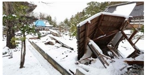
地震により倒壊した総持寺祖院の回廊＝8日、輪島市門前
