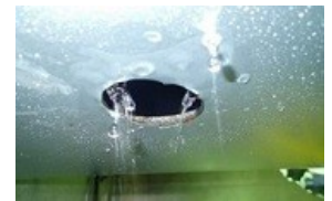
11年間点検されず、腐食により穴が開いた配管=新潟県の柏崎刈羽原発で(東京電力提供)
