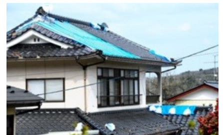
地震から約1ヵ月経っても屋根が雨漏り対策のシートで覆われた家=2022年4月13日、宮城県白石市斎川
