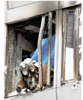
激しい炎で変形したものの、溶け落ちずに残った窓枠(17日午後、大阪市北区で)
