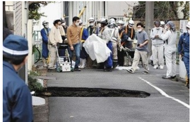
東京外郭環状道路の地下トンネル工事の影響で陥没した市道=昨年10月
