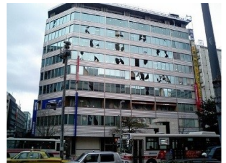
福岡沖地震で被災した天神町の福岡ビル
