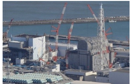
東京電力福島第一原発3号機の原子炉建屋(右)＝福島県大熊町で
