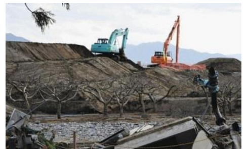
昨年10月の台風19号災害で決壊し、復旧工事が進められる千曲川の堤防＝今年4月、長野市穂保で
