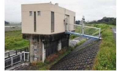
狛江市が管理する六郷排水樋管の水門 ＝東京都狛江市の多摩川で
