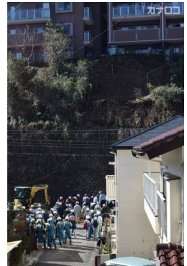
道路脇の斜面が崩れた現場を調べる消防隊員ら =6日午前11時10分ごろ、逗子市池子2丁目
