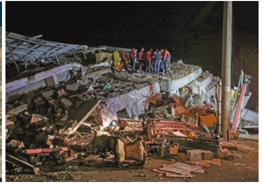
24日、トルコ東部で崩壊した建物で生存者の捜索に当たる救助当局者＝ゲッティ・共同
