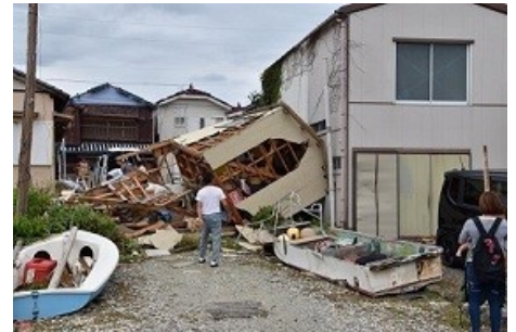
強風で倒壊した倉庫＝12日午後0時25分、鋸南町勝山
