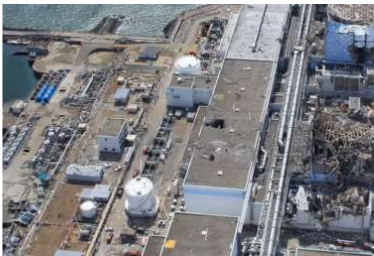
写真 5 北側から見た 3、4 号機。原子炉建屋は水素爆発により大破。屋根に大きな穴が開いているのは 3 号機のタービン建屋で、水素爆発で飛んできた原子炉建屋のがれきによる穴とみられる。
