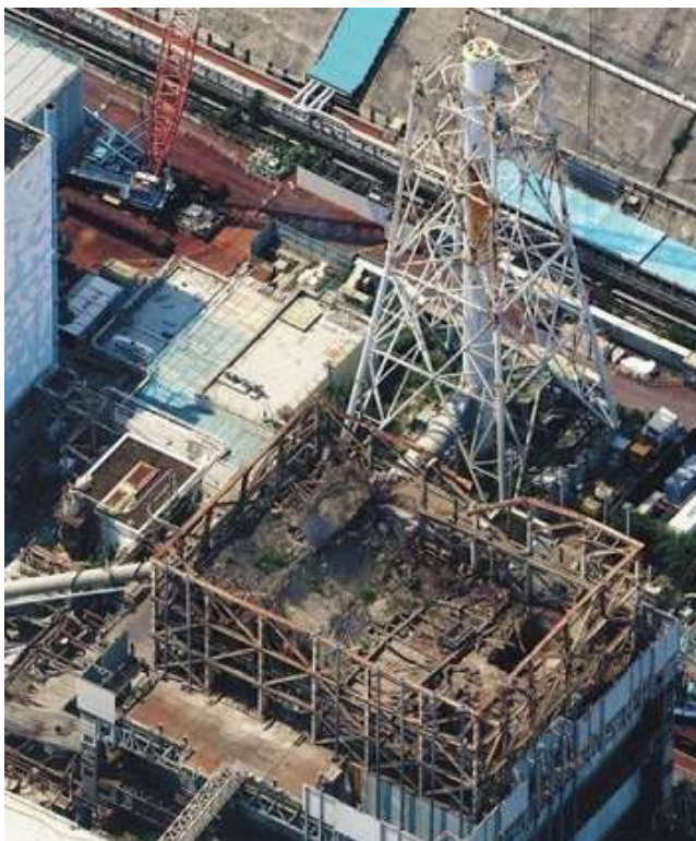
写真2 南側からの一コマ。左手前から 4、3、2、1 号機。どの原子炉建屋からも汚染された蒸気が立ち上っている
