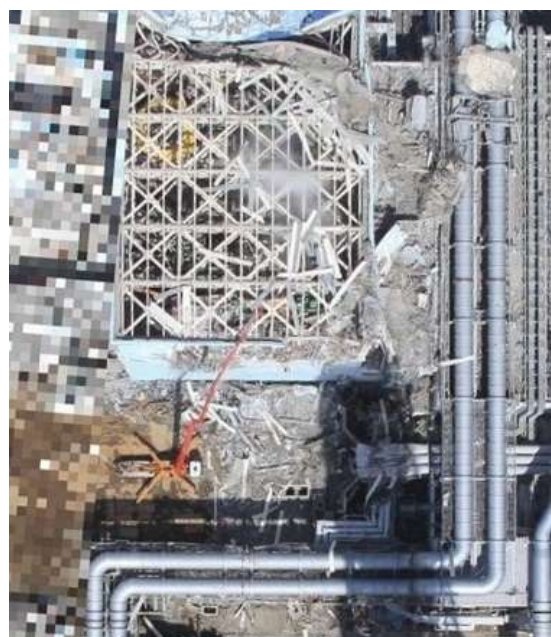
写真 8 4 号機原子炉建屋。定期点検中で原子炉に核燃料はなかったが、地上約 30 メートルにある使用済み核燃料プールには約 1500 体の核燃料があった。長いアームを備えたコンクリート圧送車を使い、冷却水をプールに送り込んでいる。
