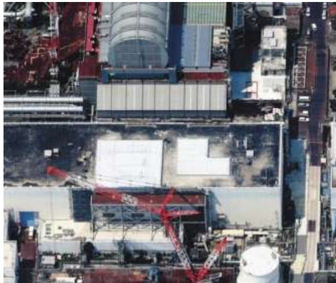
写真4 雨水が入り込み、汚染水を増やす原因となっていた3号機タービン建屋の損傷部には白いカバーが設置された。この後、防水塗装などが実施される。
