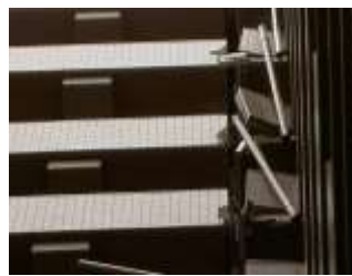
EXP. Jの衝突による手摺り壁の破壊(居住者による写真)
