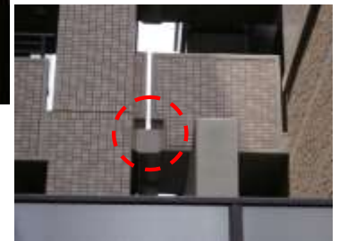
同一施工業者による同じようなEXP. Jの例。床位置よりも手摺り壁の方が先に衝突し、同じような被害が予想されるが、改善の気配は見られない。(居住者による写真)
