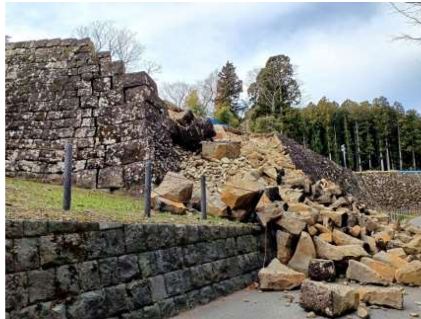
青葉城址石垣の崩壊現場
