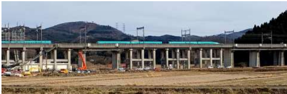
現場へ向かう農道から撮影。大きな被害は細いラーメン架構中間部の梁材に。
