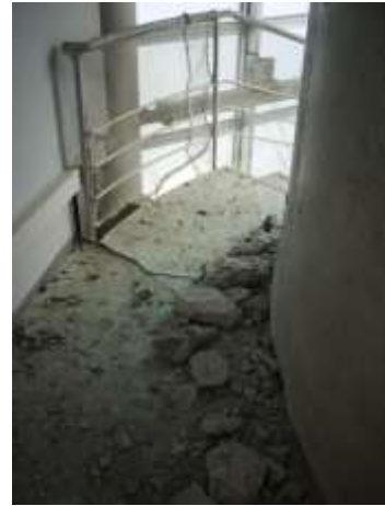
タワー階段床の剥離
