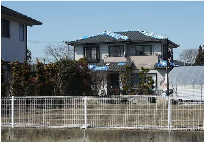
新地町の典型的な棟瓦の被害
