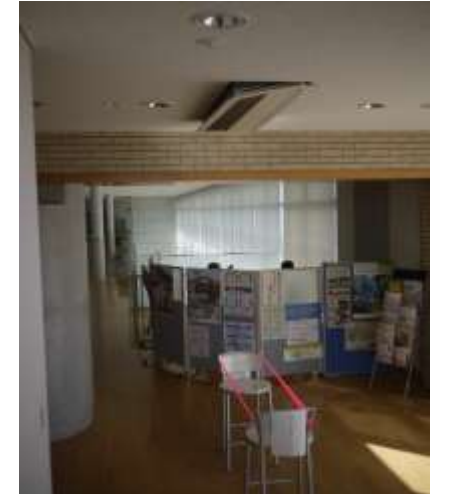
新地町役場の天井被害
