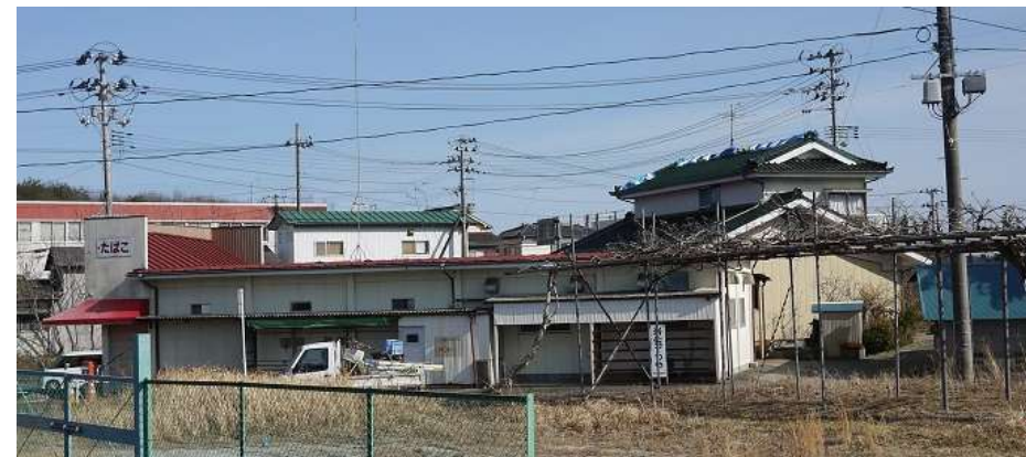
体育文化センター周辺の住家に見られる棟瓦の被害
