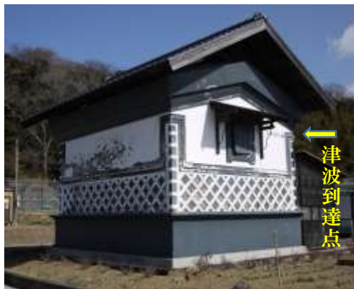
津波に耐え震災遺構となった土蔵 津波到達点
